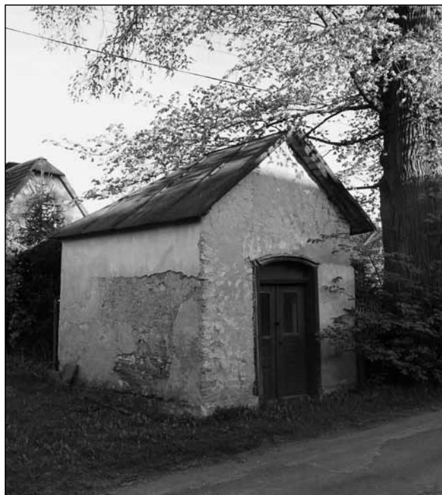
Stav kapličky před opravou.
