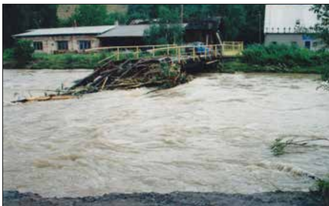
Most u pily stržený za povodně v roce 1997.
