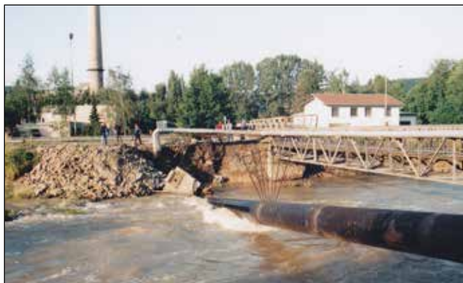
Pěší ocelová lávka v Odrách a potrubní most po povodni v roce 1997.
