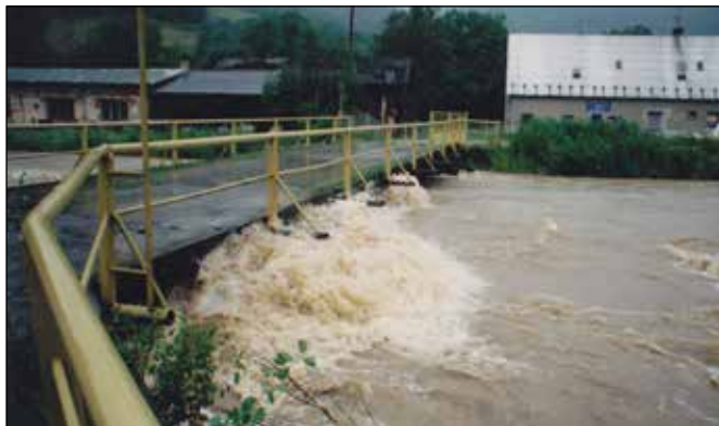
Most u pily stržený za povodně v roce 1997.
