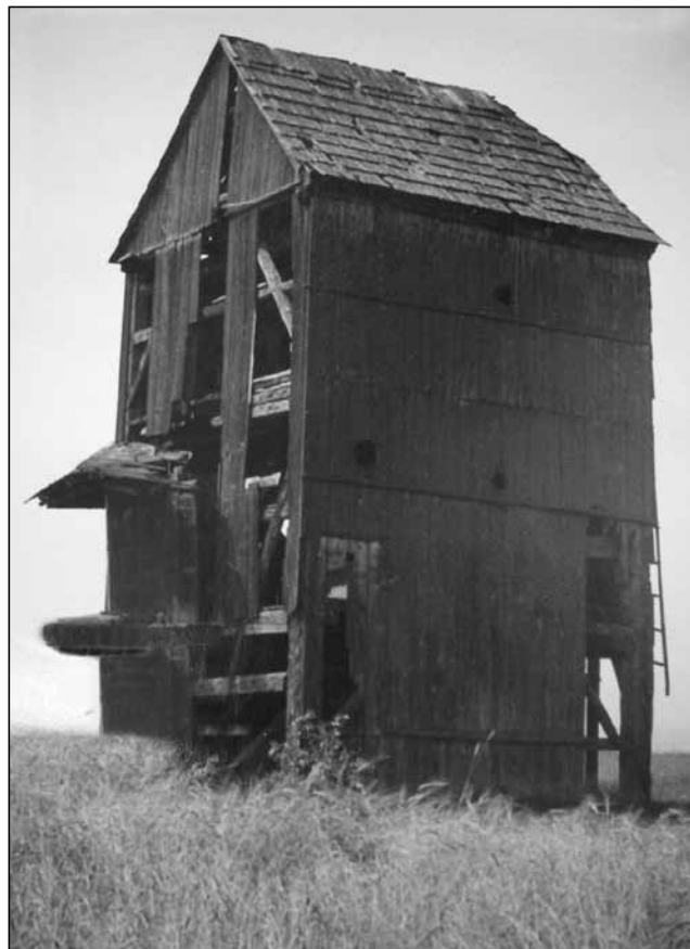
Mlýn na kótě 561 m byl již v roce 1960 dosti poškozen. (Foto Milan Tomáš, uloženo ve Státním okresním archivu Nový Jičín)
