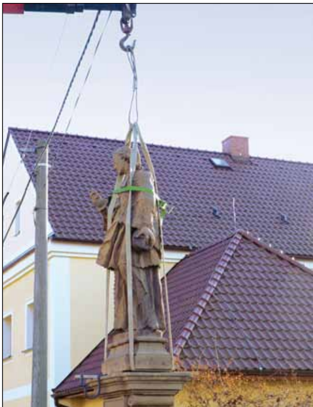
Poté bylo provedeno osazení zbylých částí – podstavce se soklem a římsou a vrchního spojeného dílu, který tvořila socha s nástavcem.
